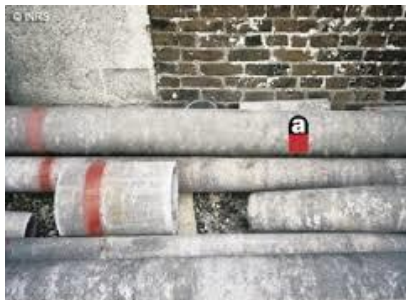
Dans les canalisations en amiante-ciment
