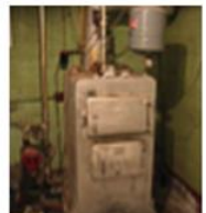
CORDONS SUR PORTES CHAUDIÈRES
