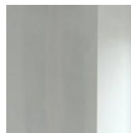
ENDUIT PLÂTRE AMIANTÉ
